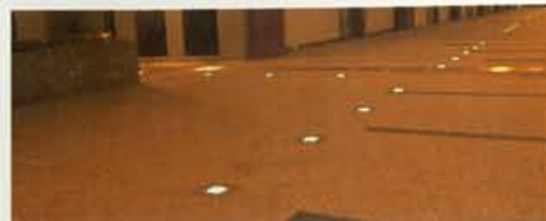
「光」による避難誘導システム
