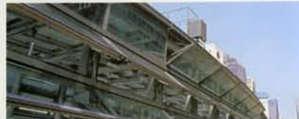
自然排煙口を有したトッブライト
