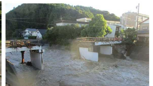
静岡県浜松市道 橋梁の一部流出 しゅうげつばし (静岡県浜松市嘯月橋)
