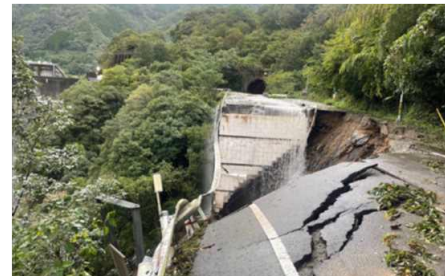
国道327号 道路崩壊 もろつかそん (宮崎県諸塚村)
