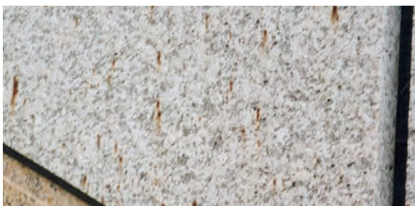
写真2 事例② 外壁花崗岩 錆色の発生状況
