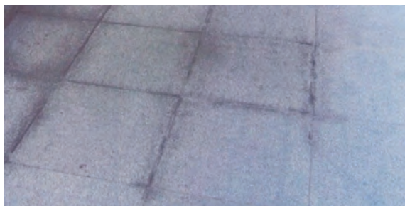
写真1 事例① 床御影石 濡れ色発生状況
