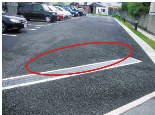
写真1 舗装が剥がれた駐車場コーナー部
