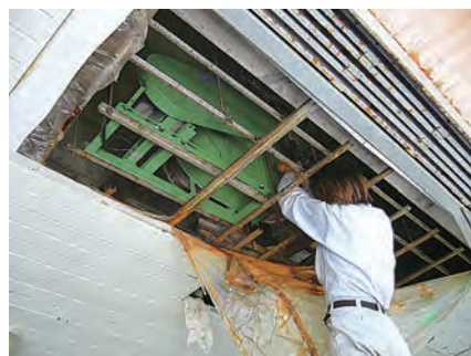
写真2 天井ボードの落下
