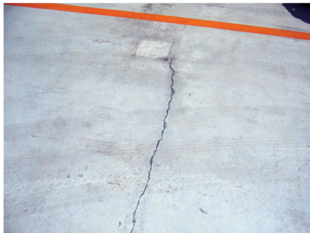
写真1 駐車場床に生じたひび割れ
