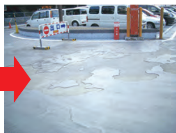
写真1 事例①のカーブ部分の塗膜防水剥離状況
