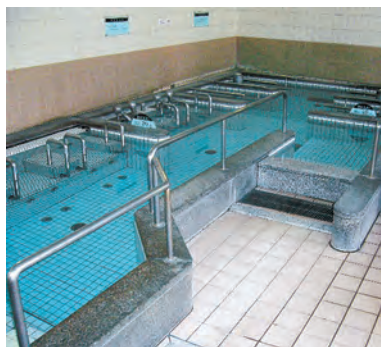
写真2 温浴施設の循環式浴槽
