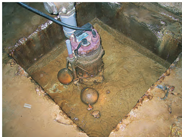
写真 2 エフロレッセンスで閉塞したポンプ
