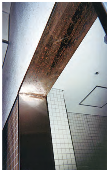
写真1 ステンレス三方枠に生じた錆
