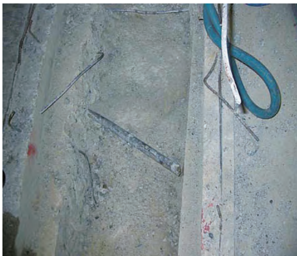
写真 1 電話線配管切断の現場状況写真
