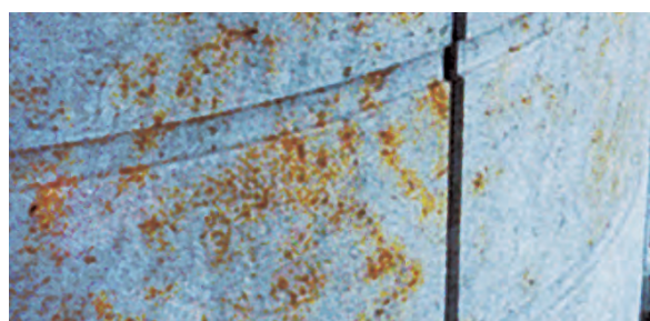
写真3 事例② 外壁花崗岩 黄変の発生状況
