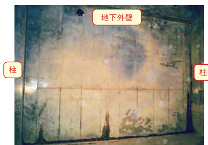
写真1 地下外壁に生じたひび割れからの漏水事例
