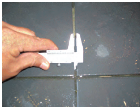
写真1 タイル目地やせの状況
