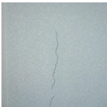
写真1 クロス表面に生じたひび割れ
