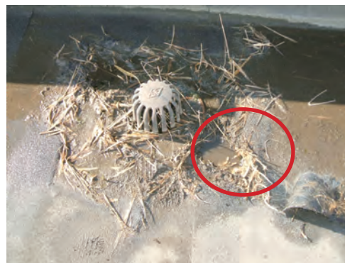
写真2 ドレン周りの防水層の中に雑草の根が入り込んだ状況
