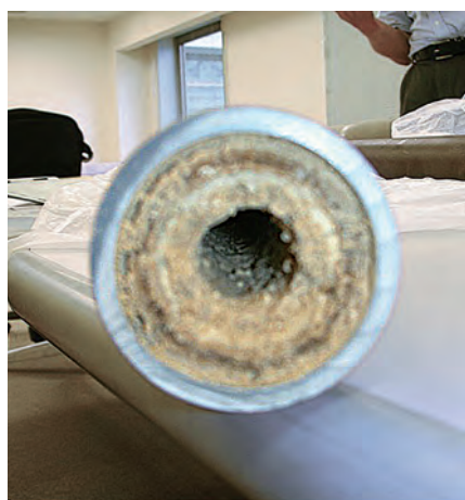
写真1 閉塞した配管の状況
