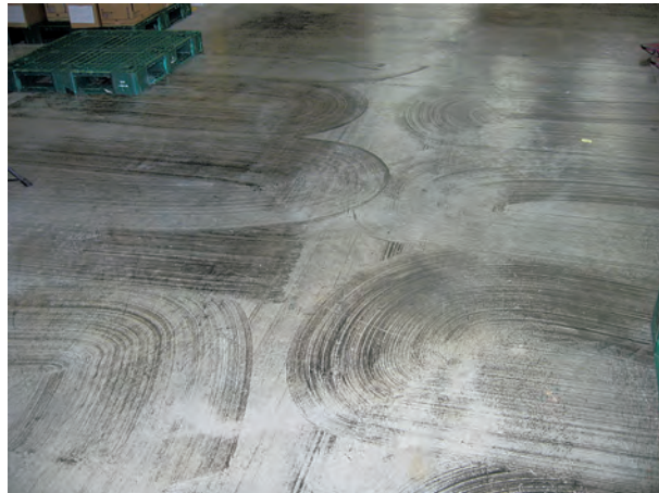
写真1 倉庫床の汚れ
