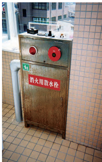
写真2 ステンレス製消火栓 BOX に生じた錆
