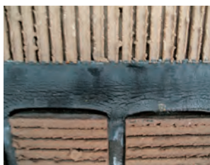
写真 2 シーリングの劣化
