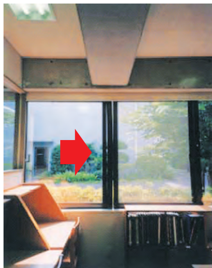
写真1 梁たわみによるサッシの変形状況
