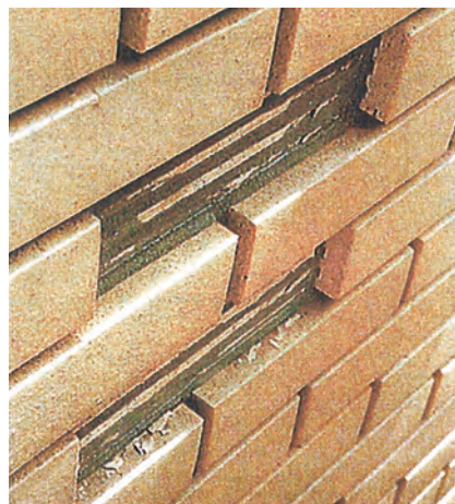
写真 1 タイル剥離状況（裏足の破断）
