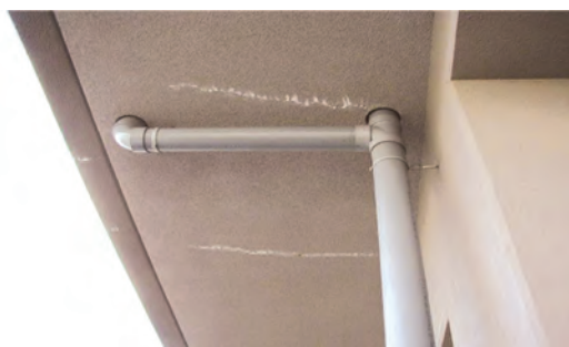
写真 1 バルコニー床からの漏水 2)
