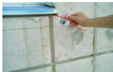
写真 1 開口隅角部の斜めひび割れ 3)
