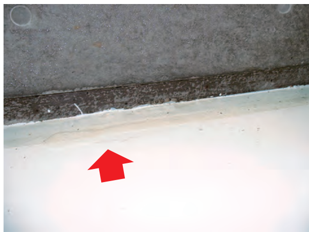
写真2 床に溜まった結露水
