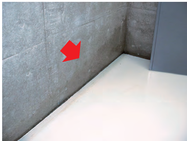
写真1 階段室壁面に生じた結露
