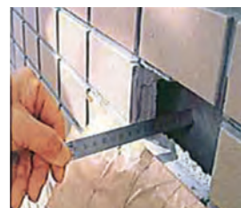
写真 3 タイルの迫出し
