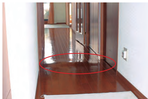
写真1 フローリングの浮き上がり
