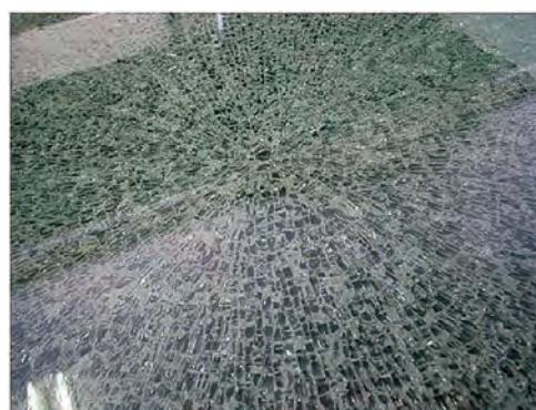
写真1 強化ガラスの破碎状況
