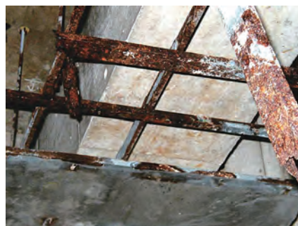
写真1 天井裏鉄部の腐食
