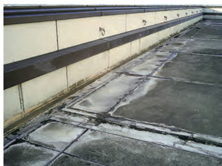
押さえコンクリートから生じたエフロレッセンス
