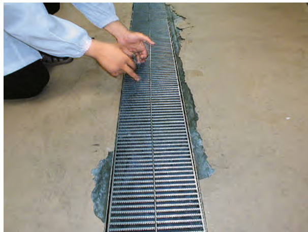
写真1 グレーチング部取合い部の塗床剥離
