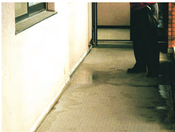
写真1 廊下床に生じた水溜まり
