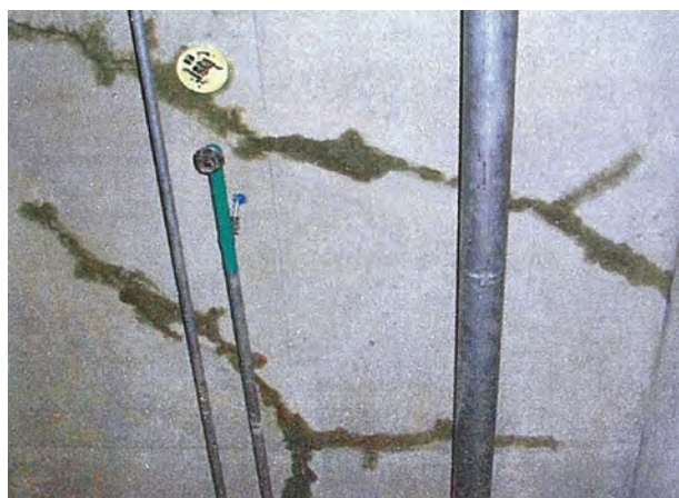
写真2 駐車場天井ひび割れからの漏水
