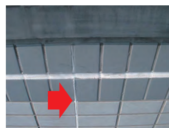
写真2 伸縮調整目地（5mm幅）の膨れ
