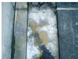
溝底に堆積したエフロレッセンス
