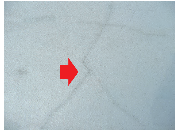
写真4 ひび割れ追従性（2年定期点検時）
