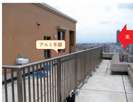
写真 1 竣工半年後の屋上ルーフバルコニー状況
