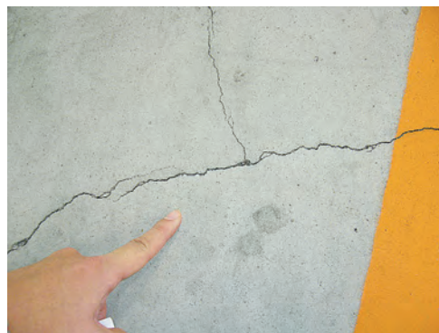
写真1 倉庫屋内床のひび割れ(0.5mm超)
