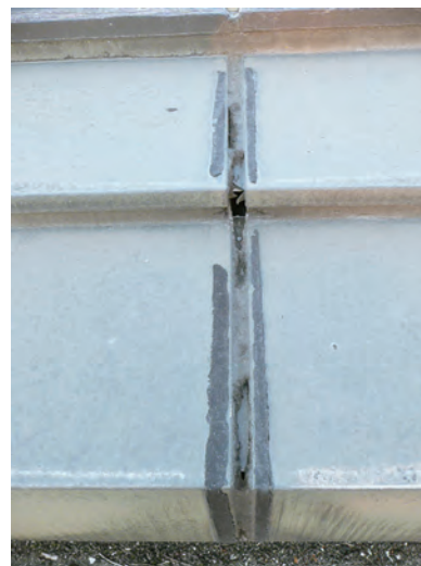
写真4 カラスによるシーリングの破損
