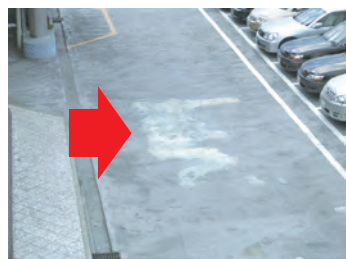
写真2 事例①の通路部分の塗膜防水剥離状況
