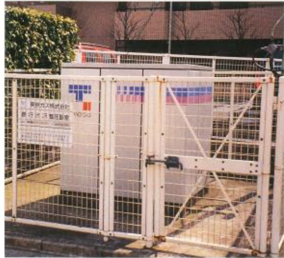
■ 地上整圧器室
