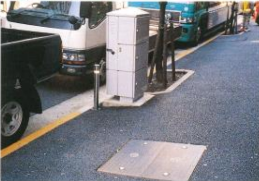
■ 地下ピット整圧器
