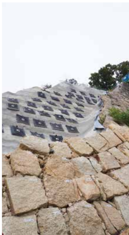
下層が出土した三の丸の石垣。石垣は豪雨の雨水を貯め込んだ地山の圧力で崩壊したと推測される。排水機能をどう担保するかも課題だ。築城当時に排水の工夫がなされていた形跡があり、その調査結果をふまえ、施工に反映することが検討されている。
