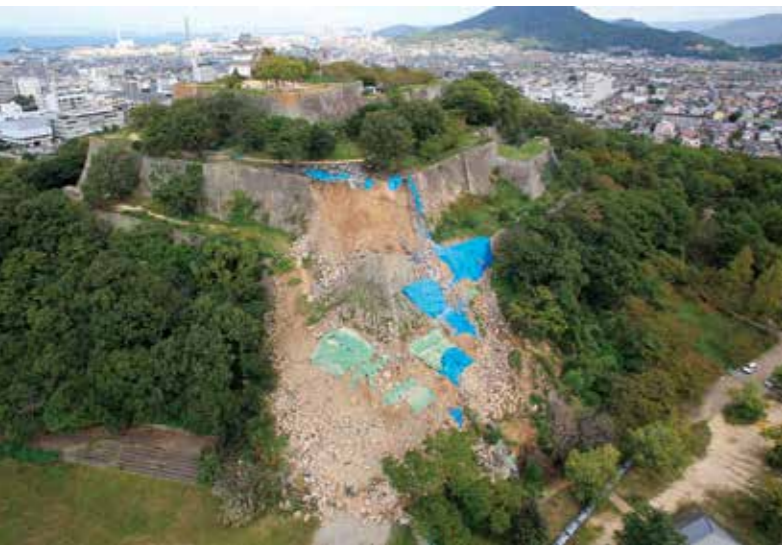
崩落直後の石垣の様子。(提供：丸亀市教育委員会)
