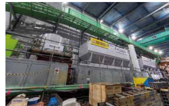
しらすをシールドで掘り進めるための薬液を配合するプラントも防音ハウス内に設置されている。
