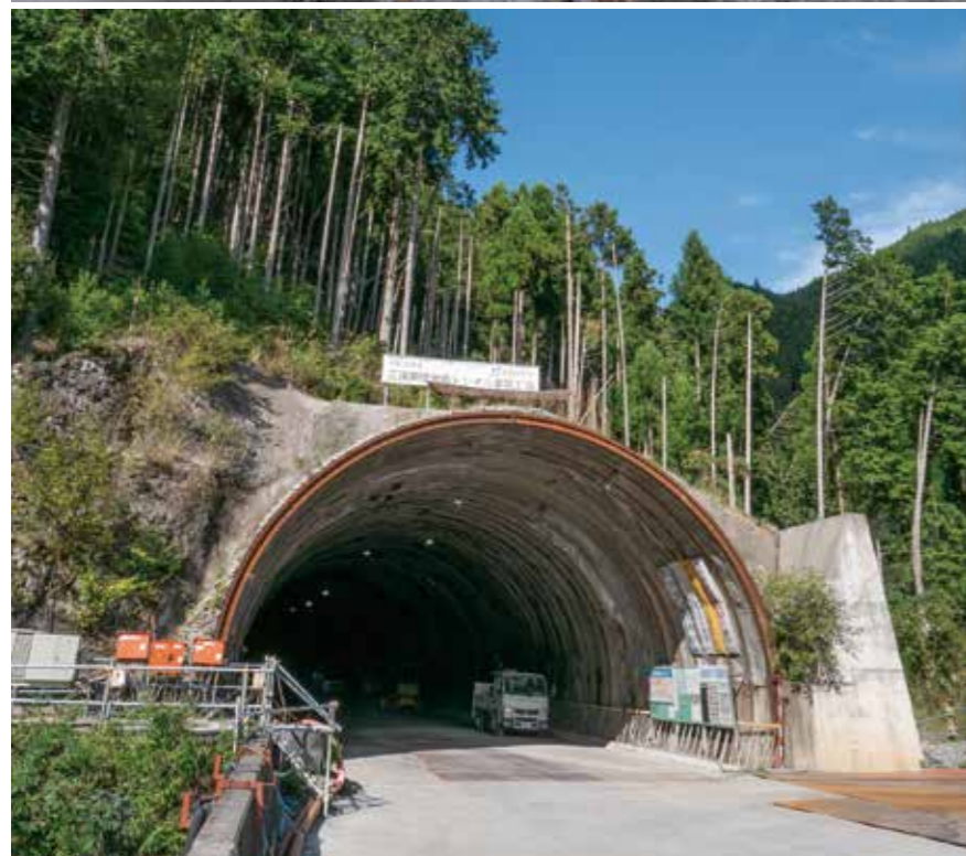
上/この先の工区を超高強度吹付コンクリートで施工した。二重支保工に切り替えた地点も見た目にはわかりづらいが、トンネルの地山側では数々の先端技術が採用されている 下/トンネル坑口の様子。開通の日が待たれる
