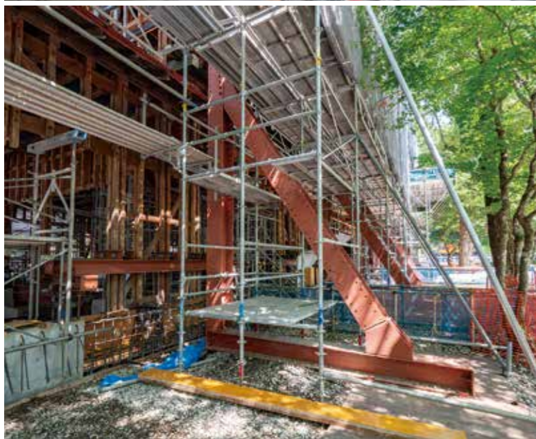
上／BIMを駆使して構造を3D化し、材料と質量のデータを付与して最適な荷重を算出。柱を鋼材で締め上げ一体的にジャッキアップする揚屋の工法を新たに考案した。木材を傷めないように締め上げる最適なねじり力などを探るため同社の技術研究所で供試体を使った実験を何度も繰り返した。 下／ジャッキアップしたアルプス館を四方から鋼材で支える。
