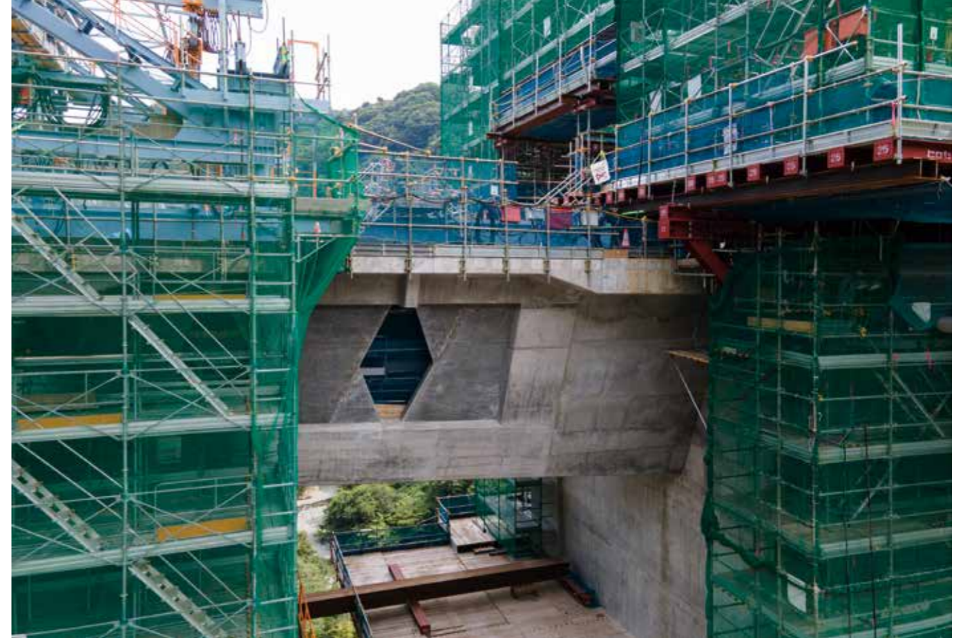
橋桁の中央付近、ひし形の開口部の両側が「バタフライウェブ」。桁内が明るくなるため、維持管理性にすぐれる。
