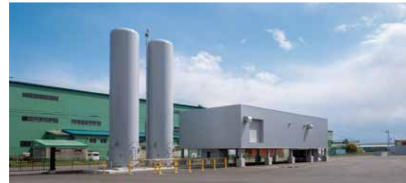
製作所内に整備された水素発電施設。水素棟は津波対策として3mかさ上げした。BCP対策として2基のタンクに副生水素を貯蔵し緊急時に発電、場内に電気を供給する。
