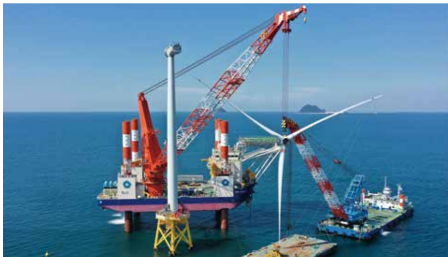
2018年に完成したSEP型多目的起重機船「CP-8001」。五洋建設は更に大型のSEP船を建造中で今後拡大が見込まれる洋上風力発電の需要に対応する。室蘭製作所は関連部材の架台、基礎部などの製作と供給の拠点となる。(提供：五洋建設株)
