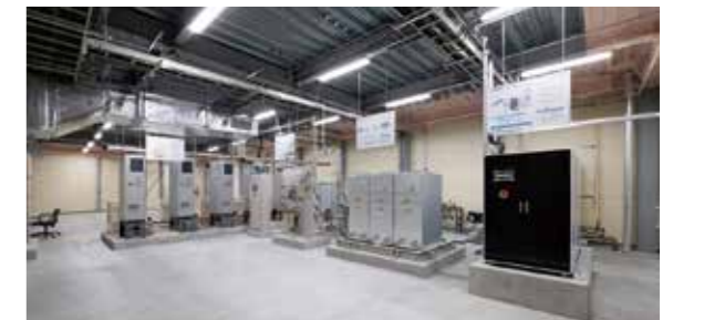
上/事務所棟の複層ガラスに貼られた採光フィルムが自然光を室内に拡散。天井に設置された照度センサー、人感センサーのデータにより照度と空調を随時自動制御しエネルギー負荷を低減する。下/太陽光発電による電力を利用してグリーン水素を製造、活用する。手前から水素を製造する水電解装置、水素を貯蔵する水素吸蔵合金、水素で発電する燃料電池。それぞれ優位性の高い異なるメーカーの機器を最適な状態で連携させている。
