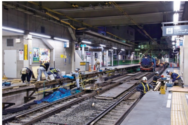
ホームの施工も深夜に行う。3月に迫った切替えの瞬間に向け、着々と準備が整えられていく。
