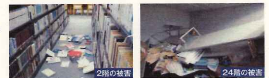
図表1 H23東北地方太平洋沖地震における超高層建築物の被害
