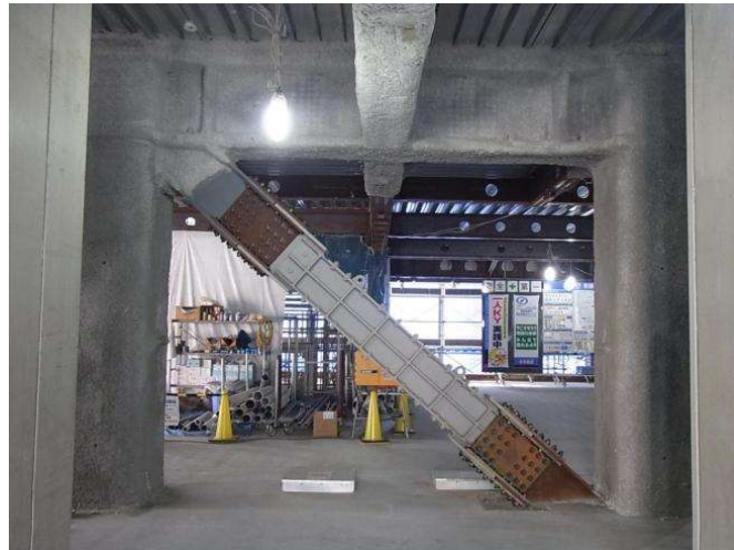
主要構造部:半乾式ロックウール 制震ブレース:無耐火被覆
