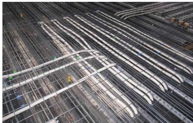
合成スラブデッキ電気配管不具合事例 (50 と配管が太く、鉄筋、デッキと接している)
