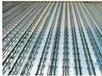
設置状況写真
