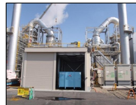
焼却炉灰出し部
