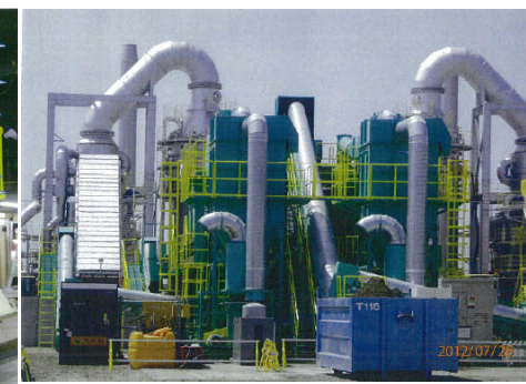
比重差選別機付帯施設
