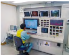
焼却炉中央制御室
