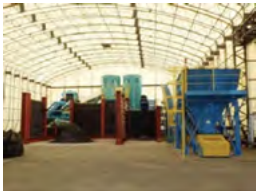
造粒固化施設
