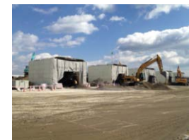
破砕機と防音設備
