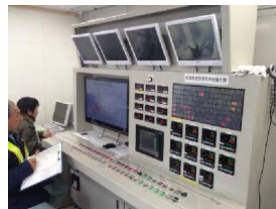
焼却炉中央制御室
