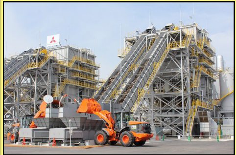
ホイールローダーによる可燃物の投入状況。左からM2、M3焼却炉
