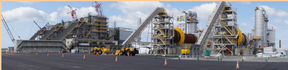
焼却炉5基の全景。(右から2番目が今回火入れを行ったJ1焼却炉)
