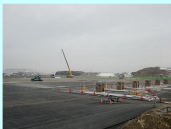
Aヤードの玄関であるトラックスケールの設置状況。1次仮置き場から廃棄物を運んできたトラックは、ここで積荷の重量を計測します。
