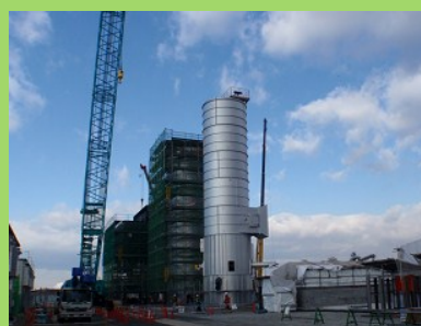
正面に見える銀色の塔は、焼却に伴って生じる排ガスを完全燃焼させて低公害化する「再燃焼室」
