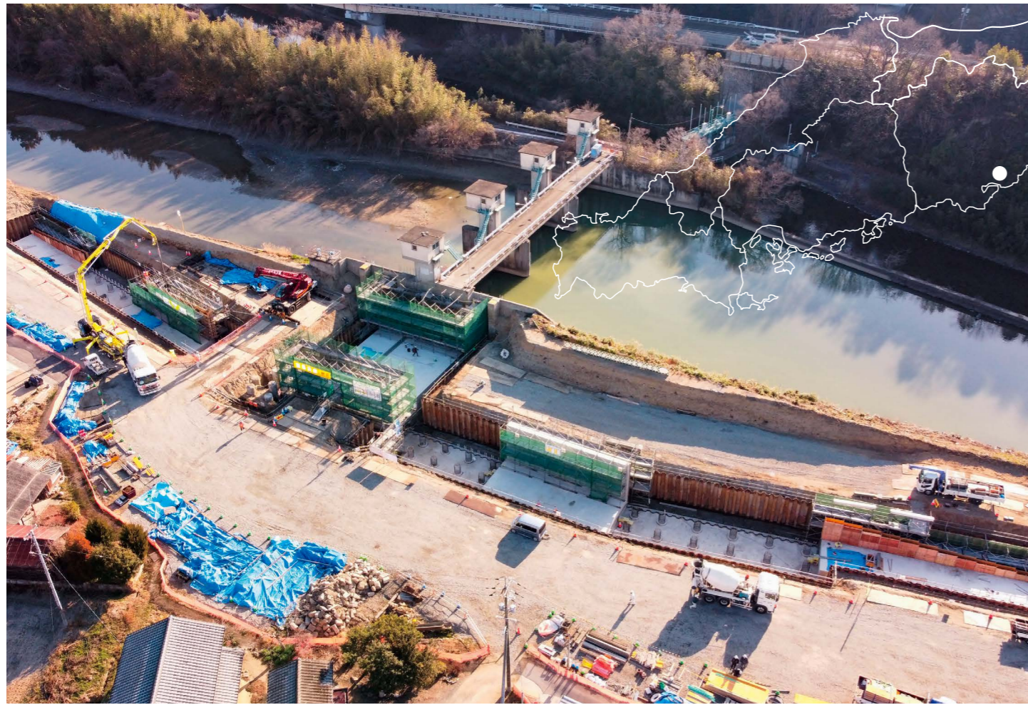
公共河川激特工事(神原堰本体工) / 岡山市東区富崎 写真提供: 岡山県
