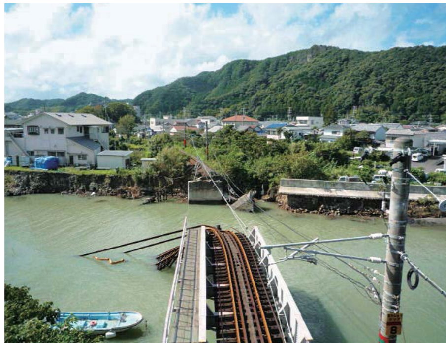
那智川の決壊により鉄道橋が倒壊 近畿地方整備局撮影 23.9.15
