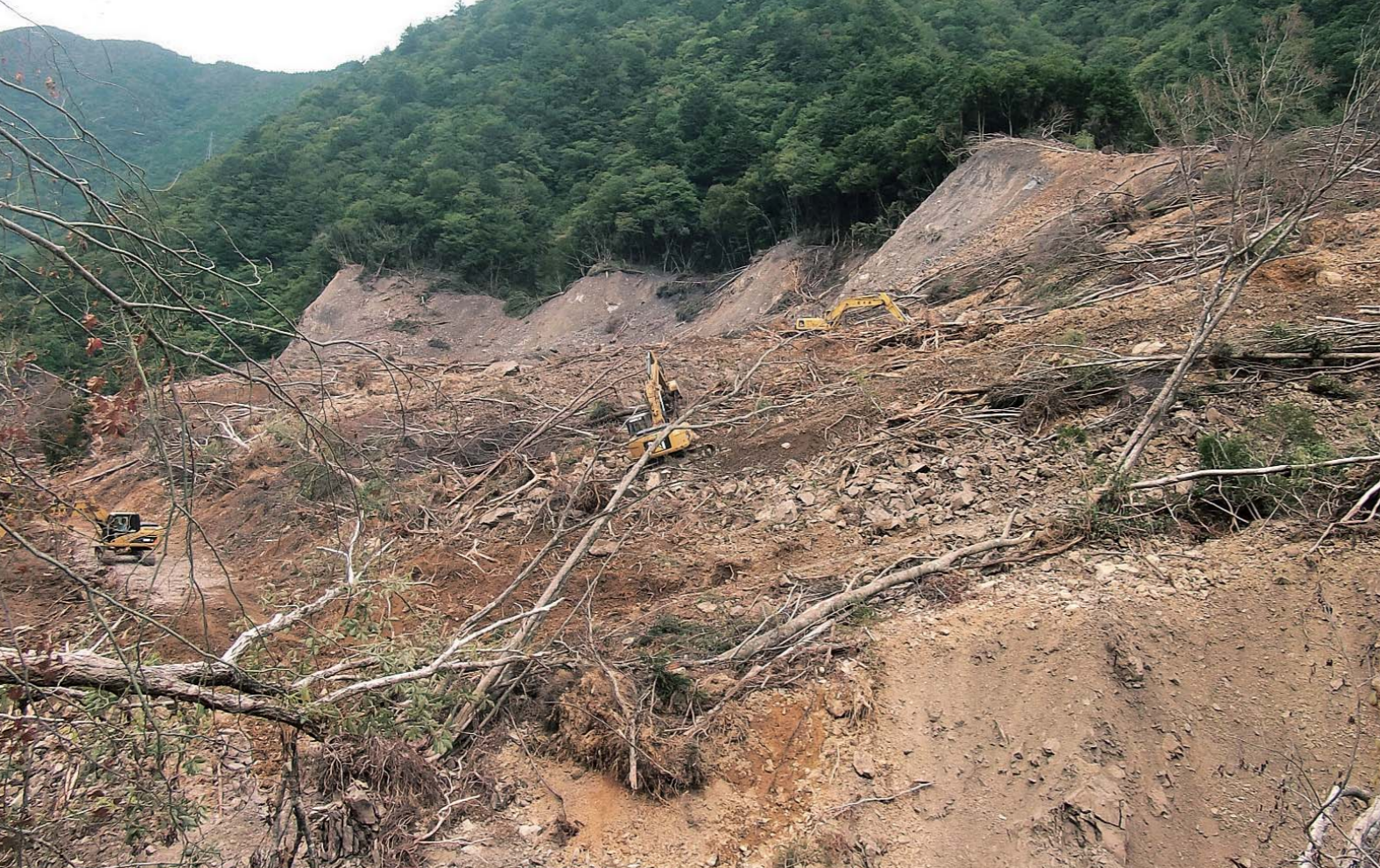
天然ダム状況(赤谷)倒木処理 23.10.4
