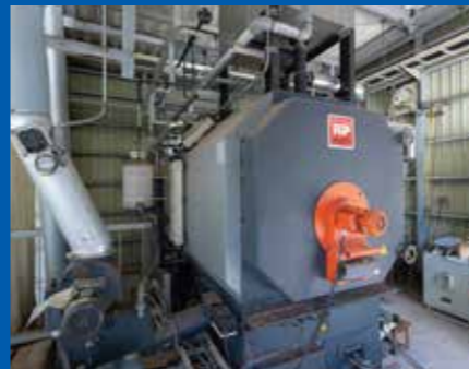
竹チップを主燃料とする、洲本市のバイオマスボイラー
