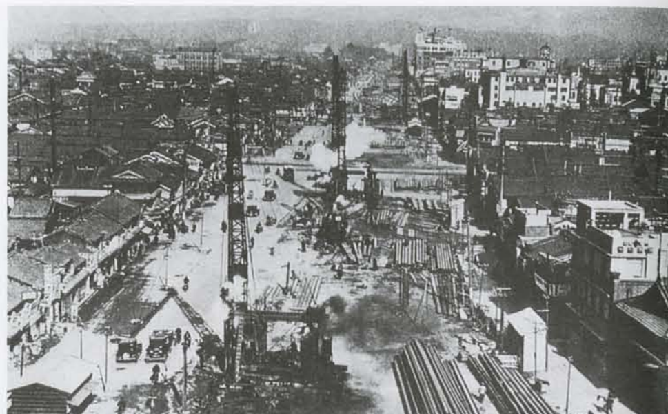
地下鉄工事難波から北をのぞむ 写真提供：大阪市都市協会
