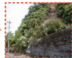
砂防関係施設により土砂・落石等を捕捉(人的・家屋被害なし)
