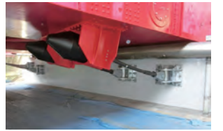
橋梁耐震化の事例
