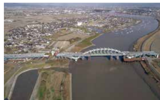
有明海沿岸道路(大川佐賀道路 早津江川橋(仮称))施工状況
