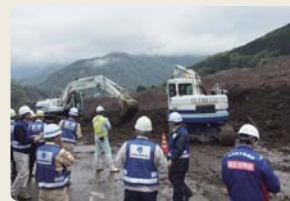
阿蘇大橋付近現地調査 (28.4.25)
