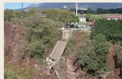
崩落した阿蘇大橋
